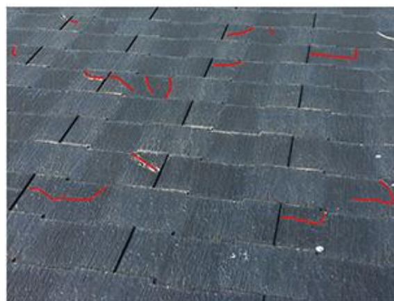
↑割れが目立つが、欠損条件が施工基準に満たされている。 *ヘアークラックの箇所は接着剤で補修して施工してください。
