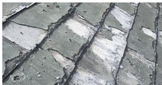
↑基材が傷みすぎている。
