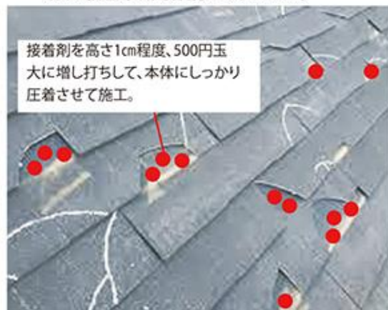
↑割れが目立つが、欠損条件が施工基準に満たされている。 *欠損箇所は、接着剤の増し打ちで施工してください。
